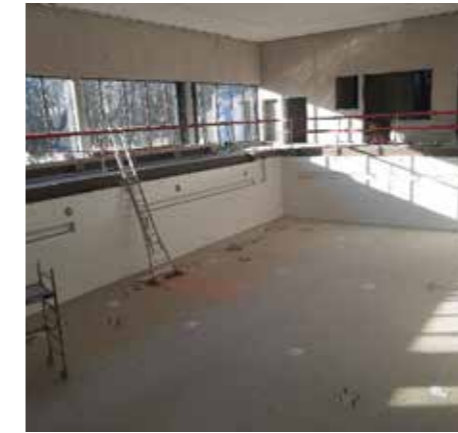
De betegeling van het zwembad wordt verder afgewerkt. De dubbele beweegbare bodem in het zwembad wordt geïnstalleerd.
